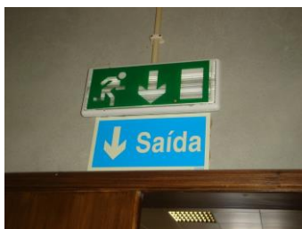
Figura 6 – Iluminação de Emergência e Sinalização de Segurança
