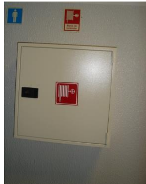
Figura 5 – boca de incêndio
