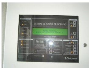
Figura 7 – Sistema automático de Deteção de Incêndios do edifício de apoio – centro escola.
